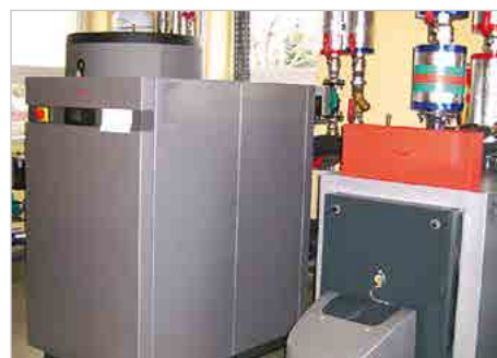
Dzigorzew Sieradz Wykorzystanie ścieku oczyszczonego do ogrzewania obiektów oczyszczalni ścieków, Dzigorzew 77
