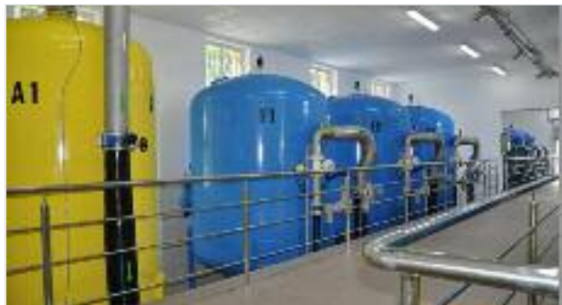
Stacja uzdatniania wody w Bolesławcu
