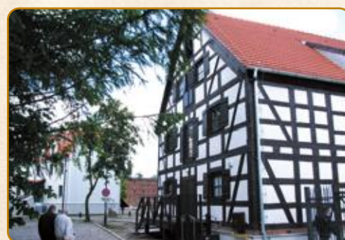
Bydgoszcz Modernizacja zabytkowego budynku „Biały Spichrz”, Dom Młynarza, Czerwony Spichrz, Kamienica ul. Mennica 2, 7, 8, 8a
